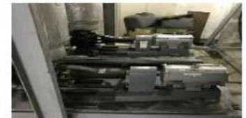
冷温水2次ポンプ
